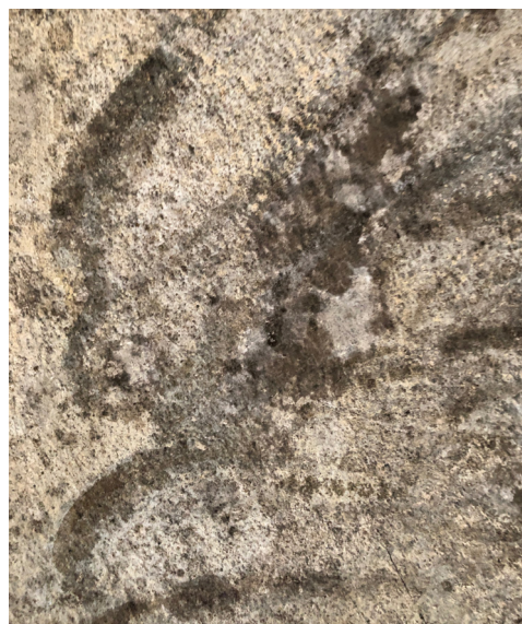
Fot. 8 Transept, detal skrzydła, widoczny intensywny porost mikroorganizmów
