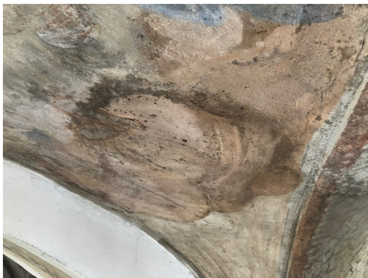
Fot. 7 Transept, widoczne zniszczenia warstwy malarskiej oraz lokalnie porost mikroorganizmów
